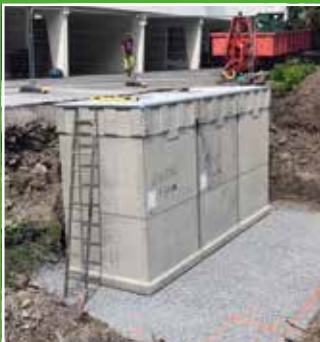
Med utgraving oppe og nede blir det enkelt å plassere betong-beholderne helt inntil hverandre.
